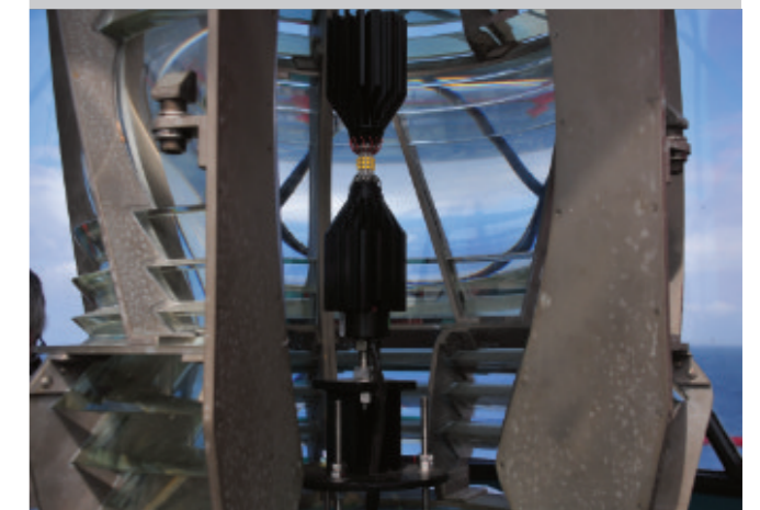
Die heutige Lichtquelle von Fanad Head ist ein LED-Array (natürliche Größe ca. 25 cm inklusive Kühlkörpern); an der Einbaustelle ist die Fresnel-Linse zu erkennen
