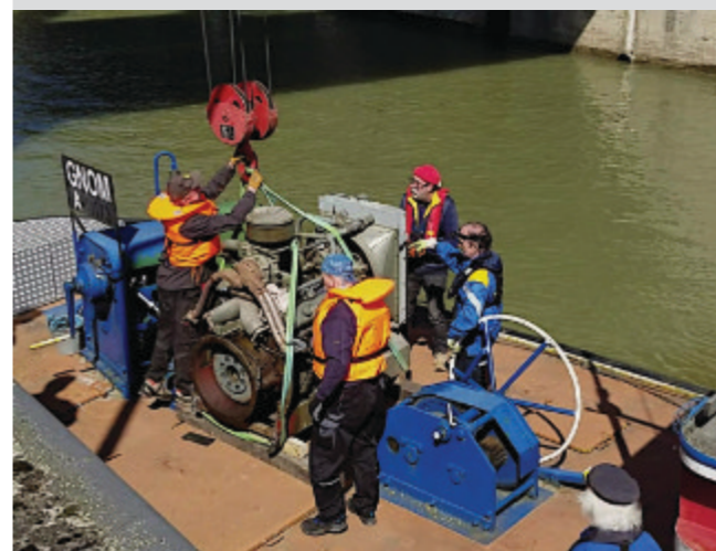
Bild 2: Nach Anheben durch den Kraftwerkskran steht die Last bereits Augenblicke später sicher an ihrem Platz am Deck des GNOM und muss nur noch verzurrt werden. (Bild: Michael Wild)
