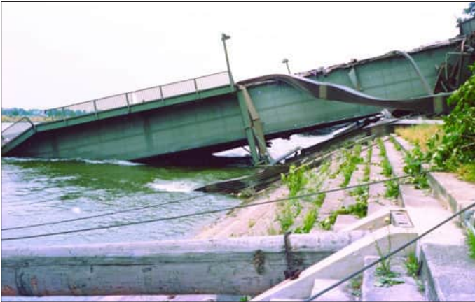
Der abgebrochene rechtsufrige Teil der Strombrücke unmittelbar beim Landpfeiler, vom Oberwasser fotografiert
